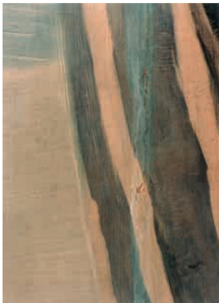
4. Zaharberritzen basi baino lehenago agerian zeuden narriadurak. Birpintatuak eta iztuku altxamenduak / Deterioros visibles antes de comenzar su restauración. Repintes y levantamientos del estuco
